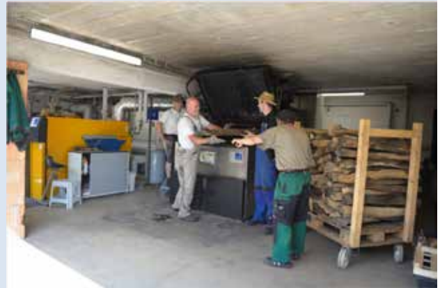
Stückholzheizung der Gemeinschaft Altenschlirf, errichtet durch die Michael-Stiftung Darmstadt.
